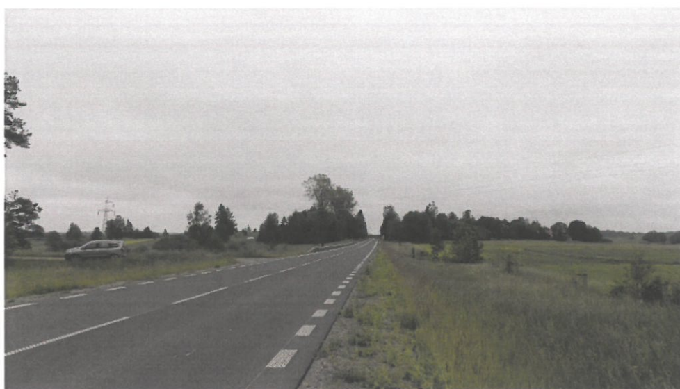
Linia 110 kV nad drogą krajową DK65
